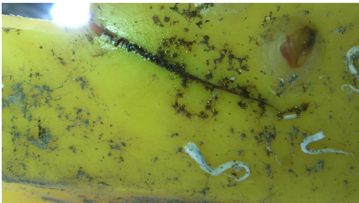
Εικόνα 3: Ρωγμή στη φλάντζα στερέωσης του ιστού της σημαδούρας.
